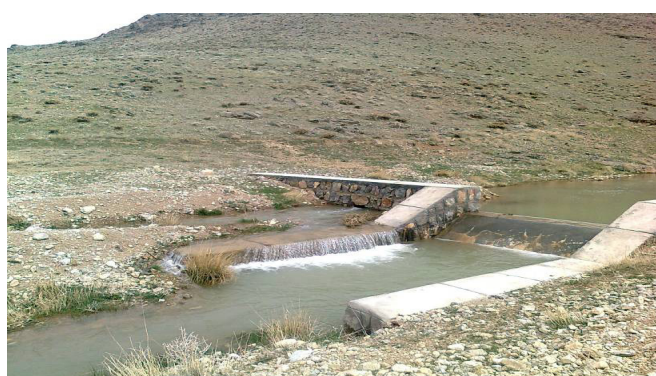
آبستگی در بزرگ‌ترین بند حوزه در اثر اجرای نامناسب
