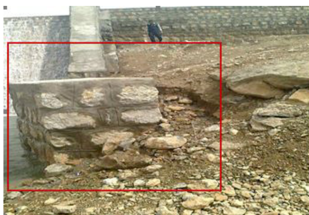
دریچه انحراف که باعث فرار آب و در نهایت تخریب دیواره سازه خواهد شد.
