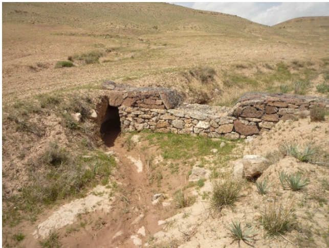
شکل ۳- فرسایش و ایجاد حفره در محل اتصال دیواره یک بند توریستی با دیواره آبراهه به دلیل عدم کفایت طول دستکها
