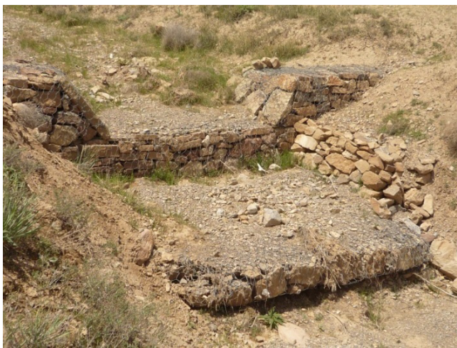
شکل ۴- فرسایش در پایین دست یک بند توریستی به دلیل عدم کفایت طول کفبند و اجرای نامناسب آن
