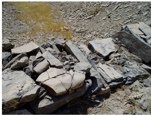
شکل ۵- مصالح نامناسب بکار رفته در بدنه بند اصلاحی خشکه چین که در اثر هوازدگی تخریب شده است.
